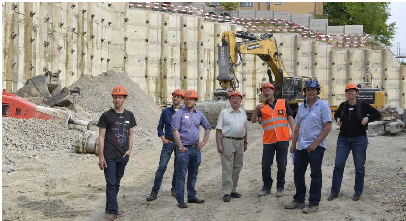
Zwischen den bis 17 Meter hohen rückverankerten Baugrubenwänden: Projektleiter Herbert Wenger von Implenia erklärt die Geologie.
